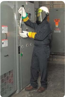
Equipo de Protección Personal, Nivel 2, determinado con estudio de Arc Flash.
