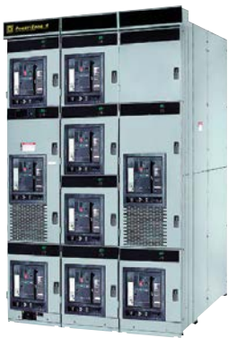
PZ4 Vista frontal compartimentos de interruptores
