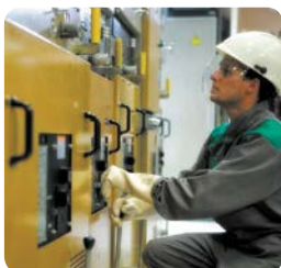
Puesta en Marcha de instalaciones eléctricas
