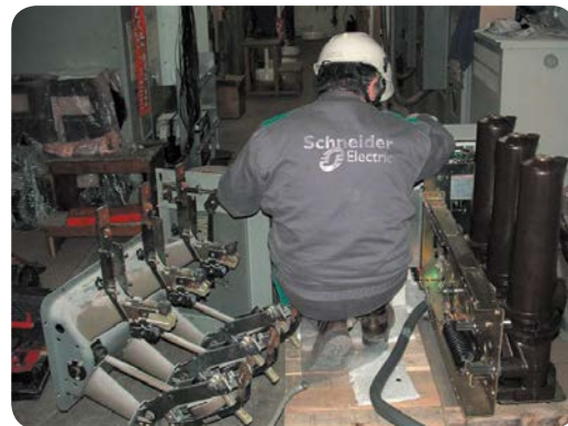
ECOFIT de un interruptor en MT.
